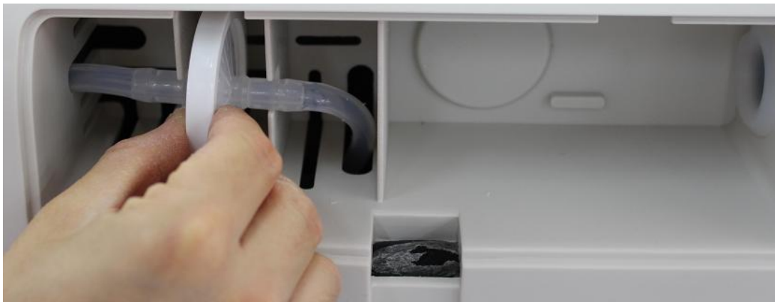
איור מס. 5 – הסרת מסנן בקטריאלי ישן ממקומו
