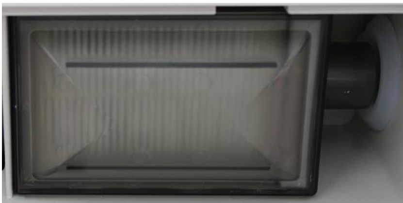
איור מס. 3 – מסנן מדחס ישן מנותק מהמתאם שלו
